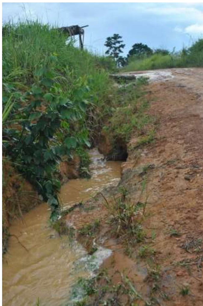
Foto: 0088 – Igarapé com água carreada da Estrada. Coordenadas: 09°37'40,1" / 63°57'33,8"
