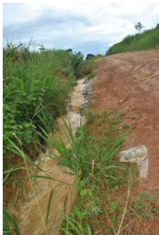
Foto: 0092 – Igarapé com água carreada da Estrada. Coordenadas: 09°37'40,1" / 63°57'33,8"
